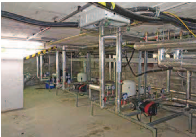
Hydraulik im Keller unter dem Sendesaal
