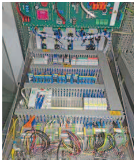
Schalttafel der Kühlanlagensteuerung
