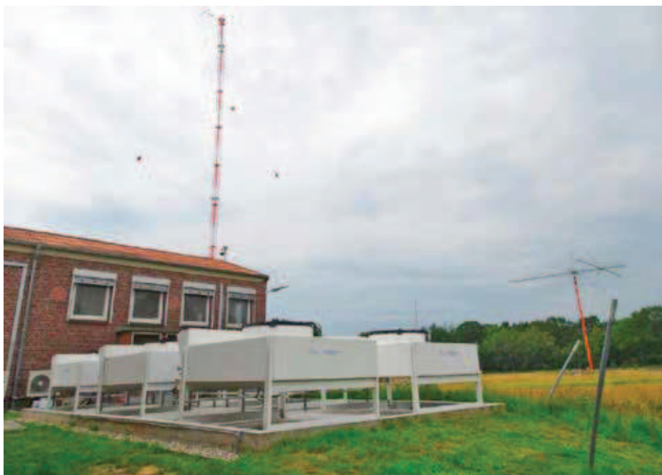
Rückkühler im Umfeld der Sendeantennen
