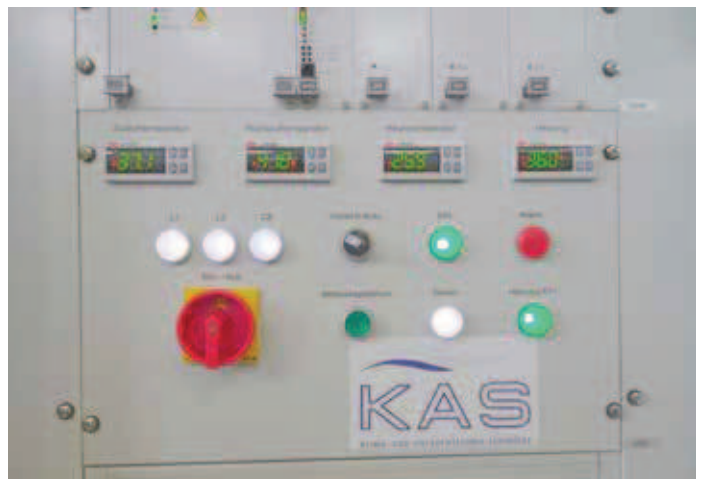
Front der Kühlanlagensteuerung
