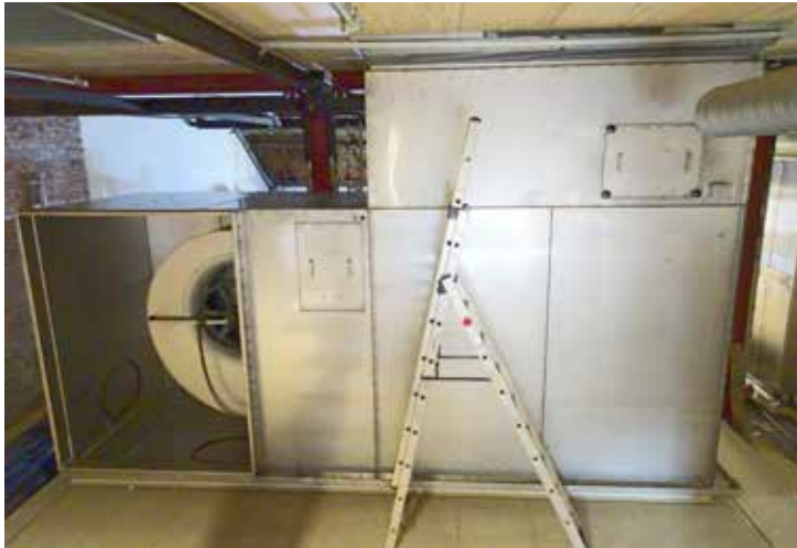
Bild: Klima- und Anlagentechnik Schindler
